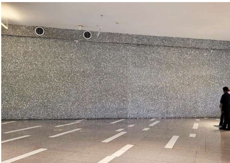
MURO A UN COSTADO DE LA TERRAZA DE RESTAURANTES AZULEJOS
