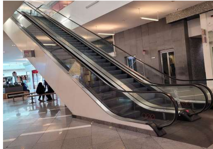
ACCESO 3, MOTOROLA PB SUBE A VANS N1
