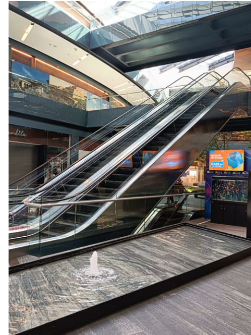
ESCALERAS ELÉCTRICAS: PB COPPEL A N1 D'EUROPE Y GOC
